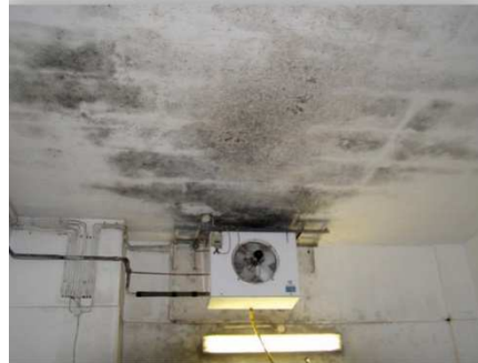
Schimmel an Decken und Wänden im Kühlhaus.
