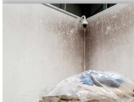
Schimmel- und Bakterienbefall in Lagerräumen
