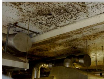
Schimmel, Bakterien und Fettablagerungen z. B. an der Decke in einer Bäckerei
