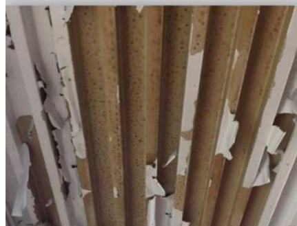
Abplatzungen durch ungeeignete Anstriche (oder fehlerhafte Verarbeitung !)
